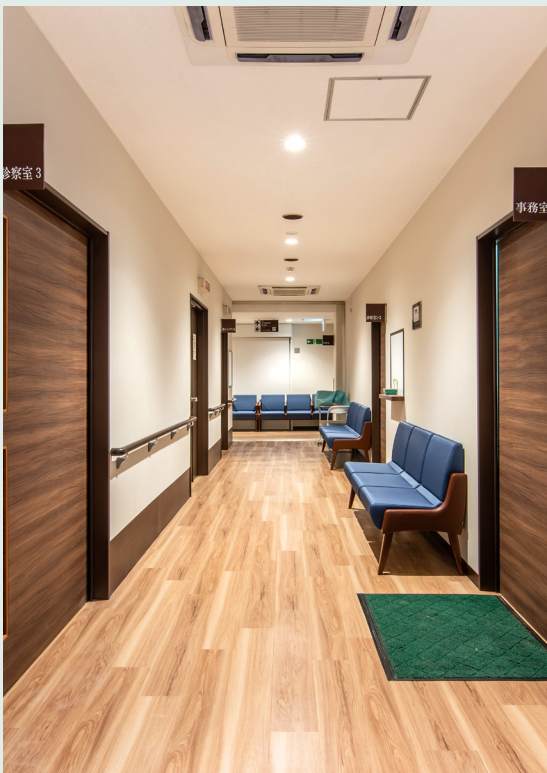
廊下の雰囲気を明るくするため、照明の交換と増設をし、床、ドアを木目に変更。施行中は患者様のご迷惑にならないよう細心の注意を計りました。
